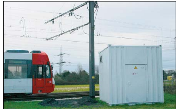
Kleiner Kasten, große Wirkung: der Energiespeicher an der Linie 1.
