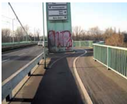
Mülheimer Brücke: kritische Pylons
