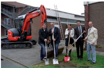
Beim ersten Spatenstich (v.r.n.l.): Architekt Ralf Rother, Bürgermeister Jörg Bukowski, Ulrike Klatt (Schulleiterin Realschule), Jürgen Greis (Schulleiter Hauptschule) und Tobias Schneider (Gemeindekulturverband). Foto: C. Buchen
