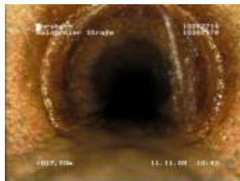
Fremdwasserzufluss über ein Kanalrohr
