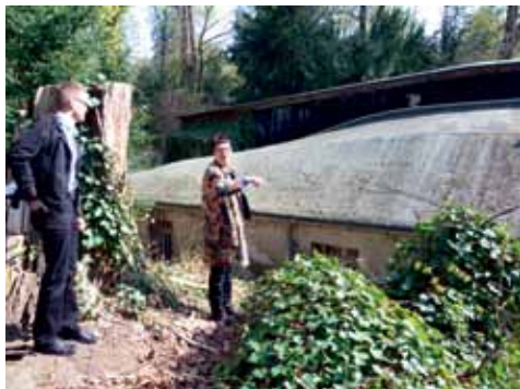
Barbara Schock-Werner, ehemalige Dombaumeisterin, sieht sich das schadhafte Dach des Forts an.
