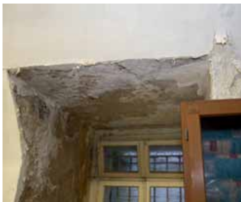
Feuchtigkeitsschäden in den Innenräumen
