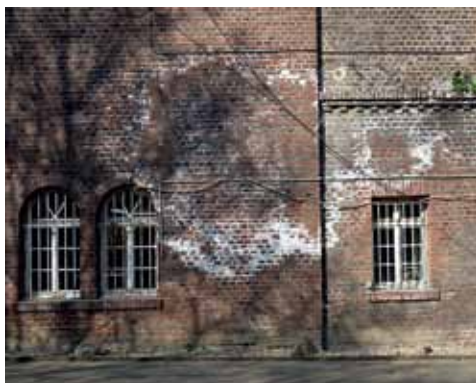
Ausblühungen am Mauerwerk durch eindringende Feuchtigkeit
