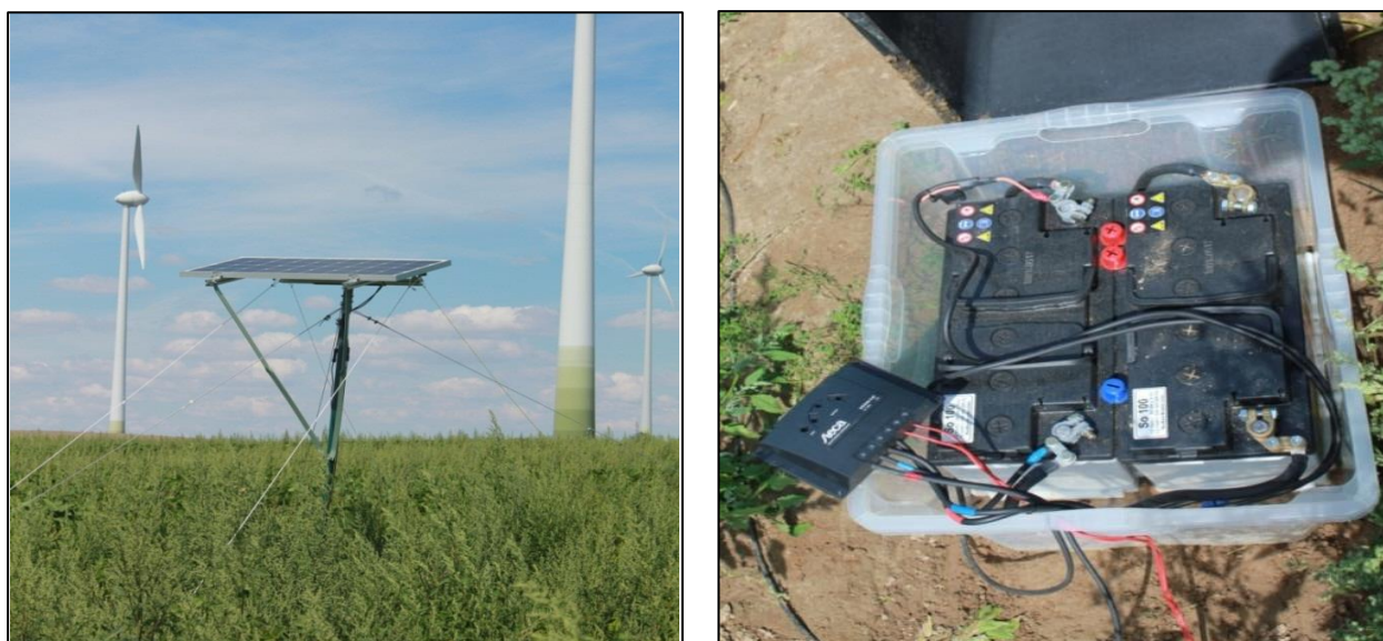
Abb. 76: Solarstation der 12V-Pollenmonitor-Messstationen (TIEM technic GbR) mit Solarmodul 12 V 80 W in 3 m Höhe auf Gestell mit verstellbarem Neigungswinkel (hier ca. 20°), rechts Solarakku-Zwischenspeicher mit 200 Ah Kapazität für mindestens 5 Tage Pufferlaufzeit (2 Solarbatterien 12 V à 100 Ah parallel geschaltet) und Solarregler. (Bilder: Hofmann)
