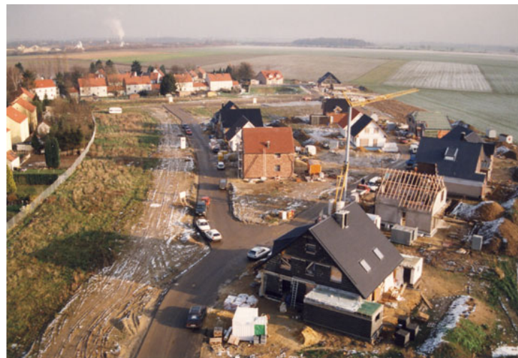
Abb. 18: Ein neues Wohngebiet entsteht am Frelenberger Gürzelweg. Hier der Stand der Bauarbeiten im Dezember 1999. Foto: Stadt
