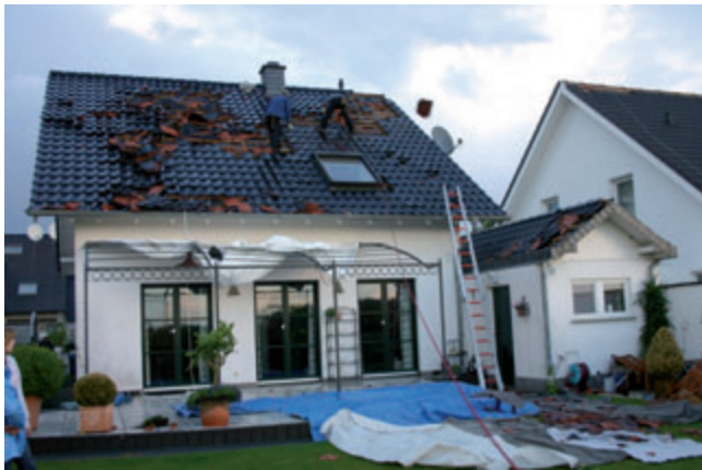
8 Sturmschäden in Roggendorf (Bildstelle BF Köln)
