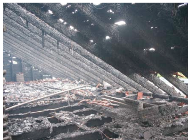
Dachstuhlbrand in Ossendorf
