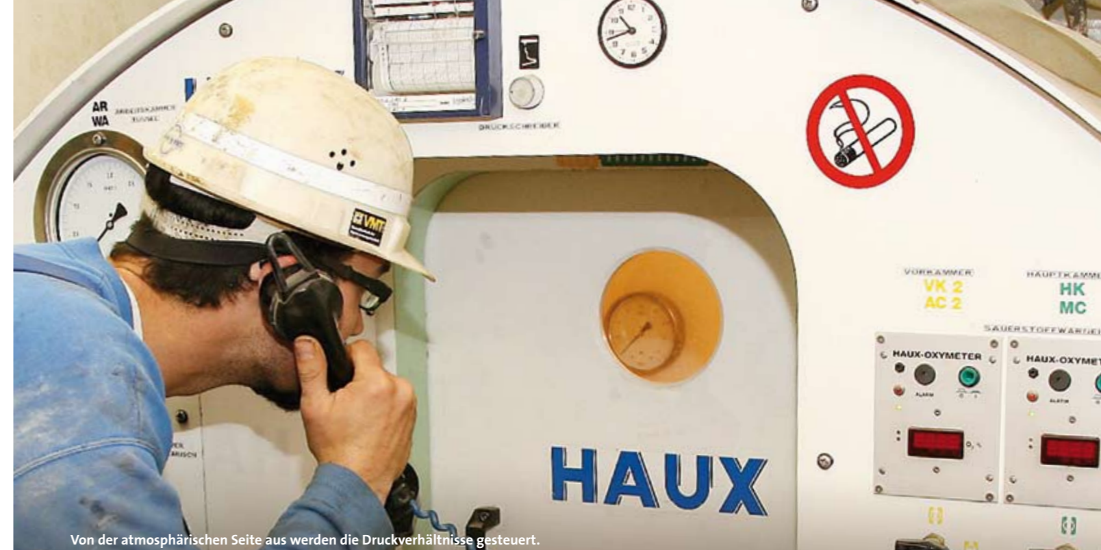
Von der atmosphärischen Seite aus werden die Druckverhältnisse gesteuert.
