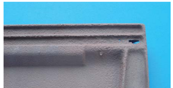
Durchgerosteter gusseiserner Dachziegel
