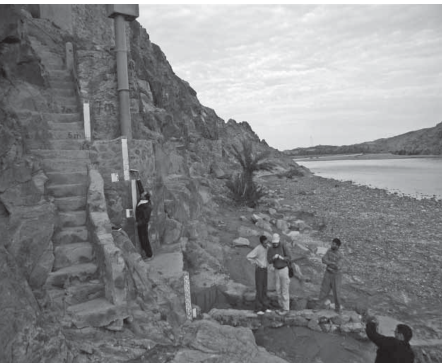
Pegelmessstation am Oued el Mellah, Marokko
