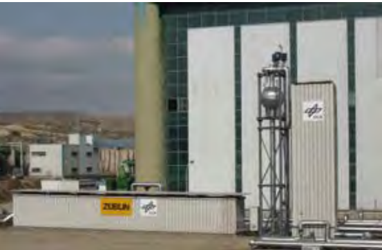
Demonstrations-Kombi-Speichersystem aus Beton-Feststoffspeicher (links) und Latentwärmespeicher (rechts)
