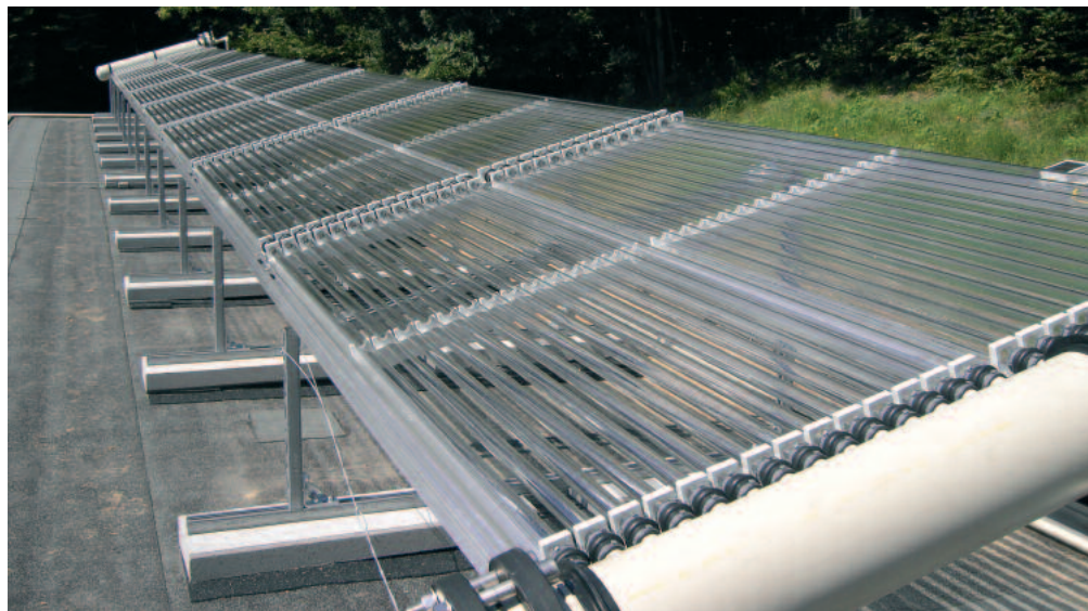
Wasserreinigung mit der Kraft der Sonne
