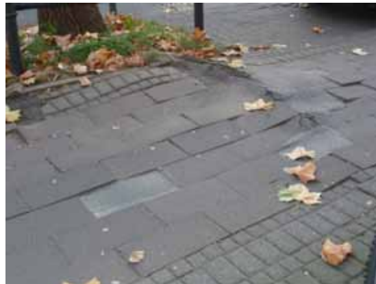
Mangel 1: beschädigter Untergrund
