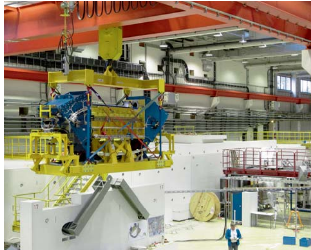
Installation des neuen Elektronenkühlers beim Jülicher Teilchenbeschleuniger COSY
