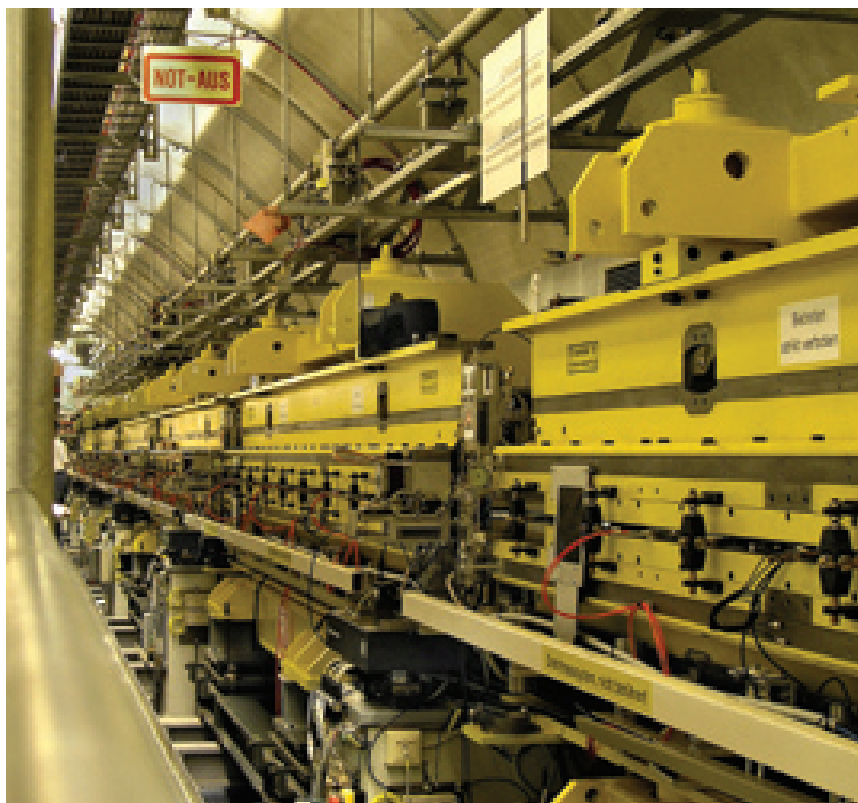
Abb. 13: Ansicht der neu installierten Sensormodule am Undulator (erkennbar an den hellroten Zuführungskabeln). Diese lokalen Messstellen erfassen die Dosis unmittelbar am Strahlrohr. Gleiche Sensorspulen befinden sich auch auf der Rückseite des Undulators, so dass eine rechts-links Asymmetrie festgestellt werden kann (Siehe Abb. 14).
