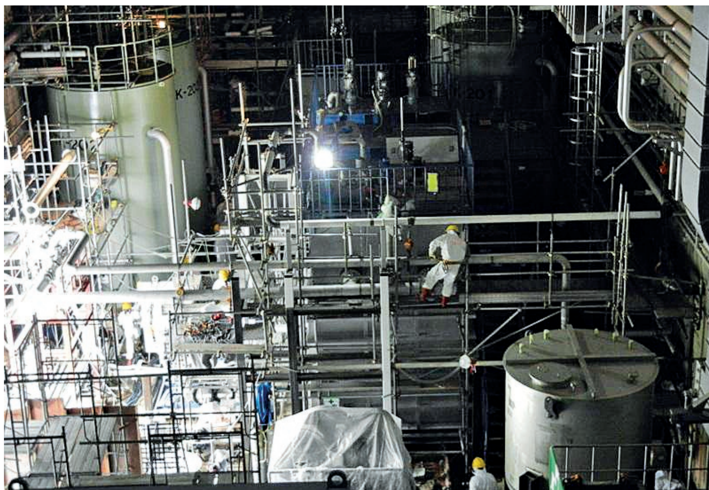
Abb. 6.5: Blick in die Wasseraufbereitungsanlage (Quelle: TEPCO).
