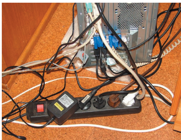
Schaltbare Steckerleiste mit angeschlossenen Geräten
