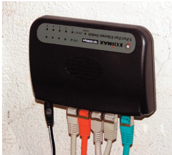
Switch eines Kabelnetzes
