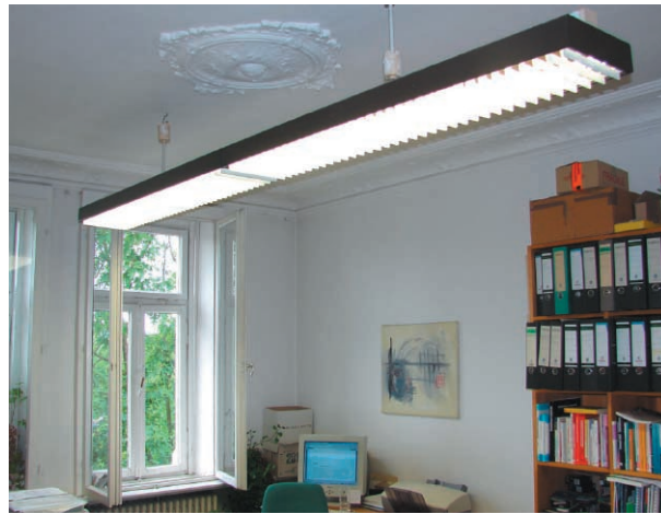
Deckenleuchte mit Leuchtstoffröhren
